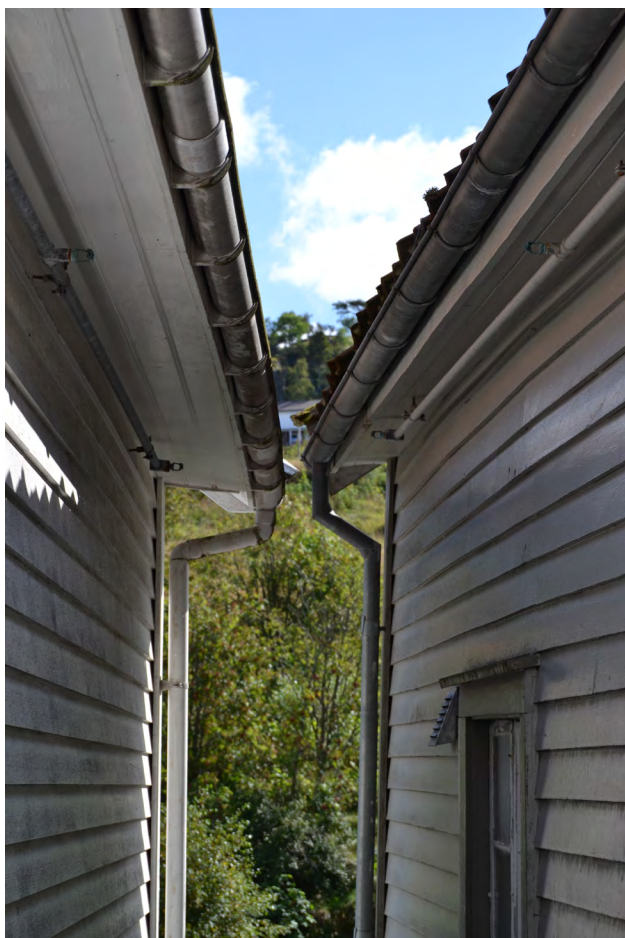
Eksempler på taknedløp, den i grå/sink har skarpe bend og kne. Foto: L. Riese
