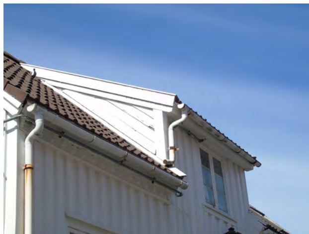
Eksempel på Stavangerark. Her med taknedløp på neste takflate. Noe som ikke er vanlig og som vanligvis ikke tillates. Foto: Solveig Roti Dahl, RFK.
