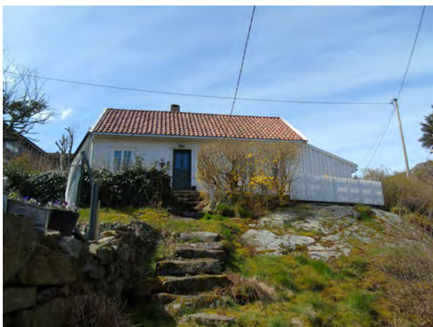
Trapp i naturstein, her vil det være vanlig vedlikehold å legge på plass stein som har glidd ut av posisjon. Foto: Solveig Roti Dahl, RFK.
