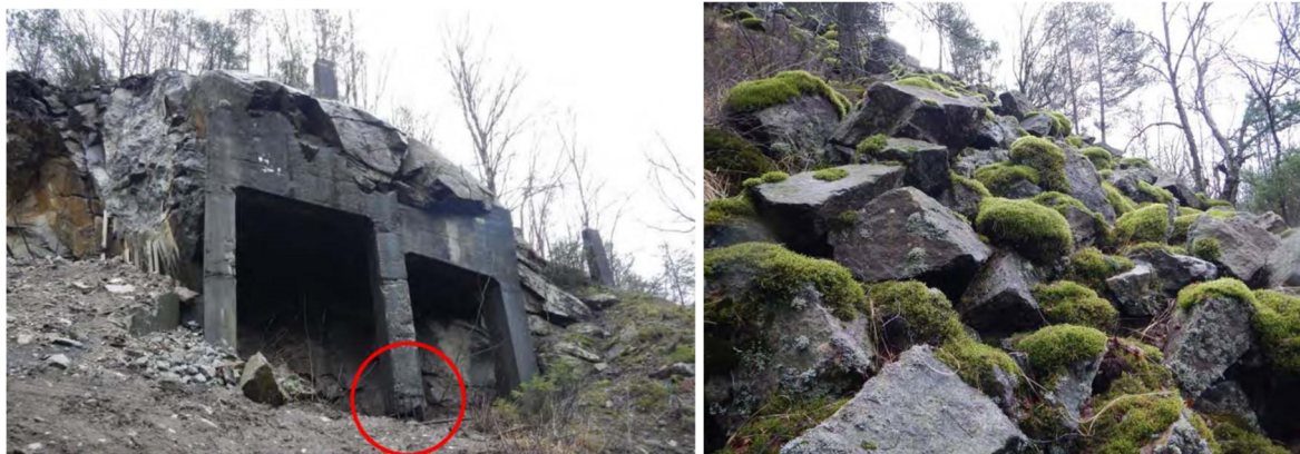
Figur 20: Område C. Betongkonstruksjon i forkant av fjellet. Forvitringsskader i betongen. Kilde: Multiconsult, rasvurderingsrapport.
